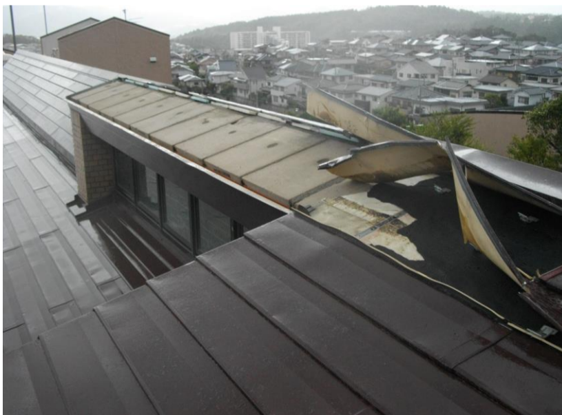
台風21号による被害で図書館建物が一部損壊
