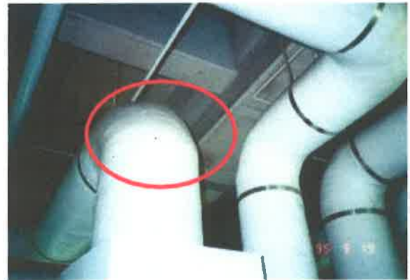
保温材（配管等）
